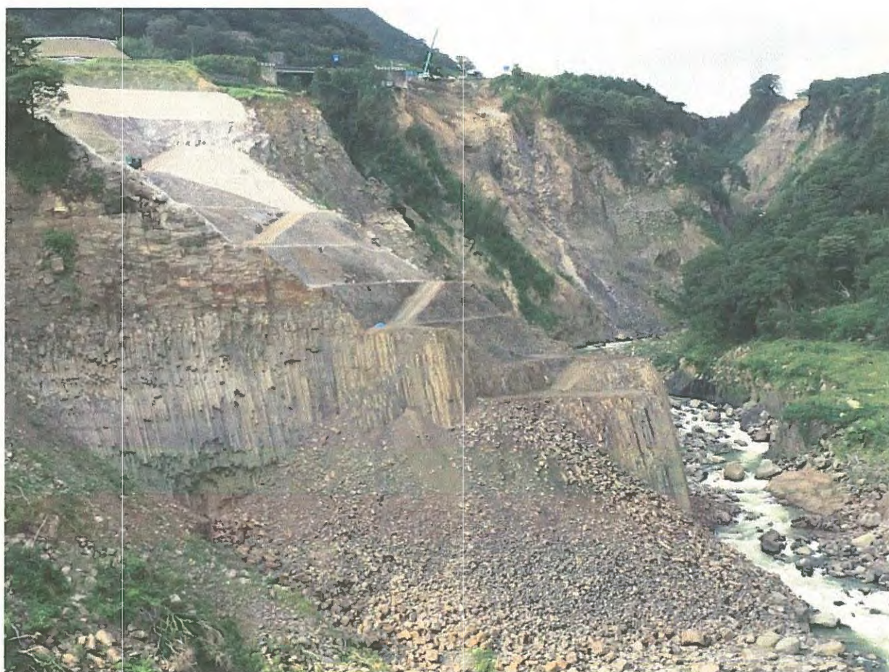
破壊された柱状節理(2017年8月30日撮影)
