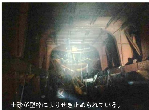
写真－１ 仮排水路トンネルの土砂堆積状況
