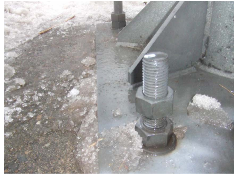
ボルトの緩み (施工不良)
