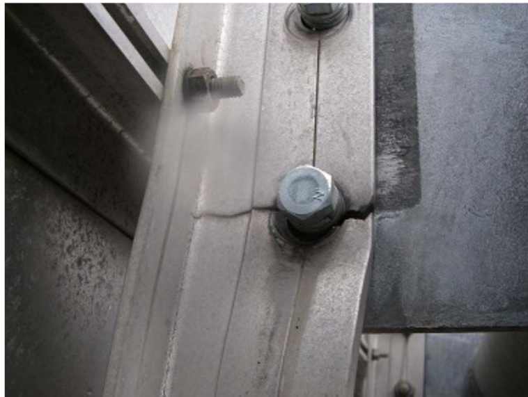
き裂損傷 (車両衝突)
