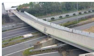
ロッキング橋脚を有する橋の落橋
