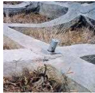
写真 受圧構造物の破損の例
