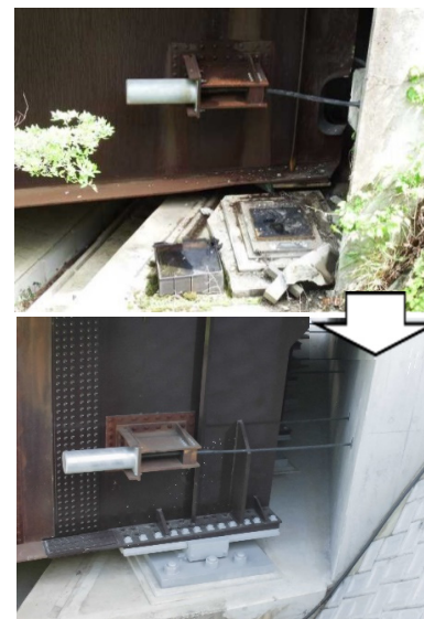
③支承の破損
