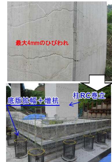
④橋脚のひびわれ
