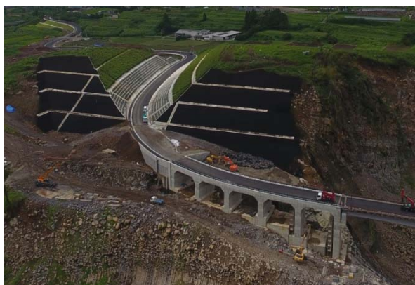
斜面崩落の影響を受けにくい構造形式の採用と線形の見直し
