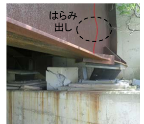
支承の直上部の主桁にはらみ出しの変形
