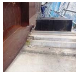
支承部が破損して主桁が橋座に脱落して損傷
