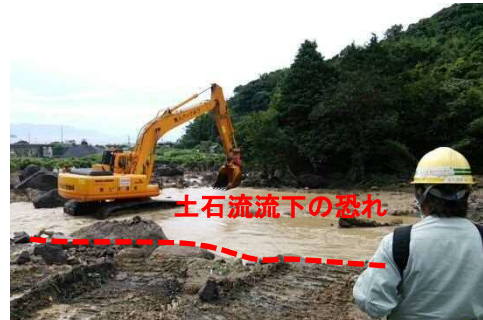
H27 鹿児島県垂水市深港川の土砂崩落現場
