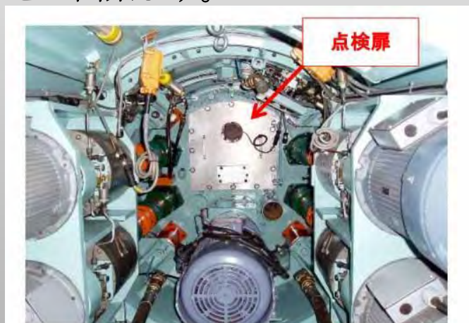
掘進機内状況
