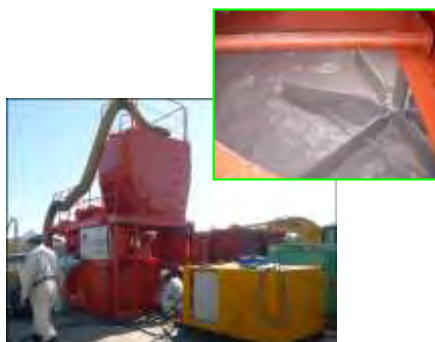
写真 スラリープラント
