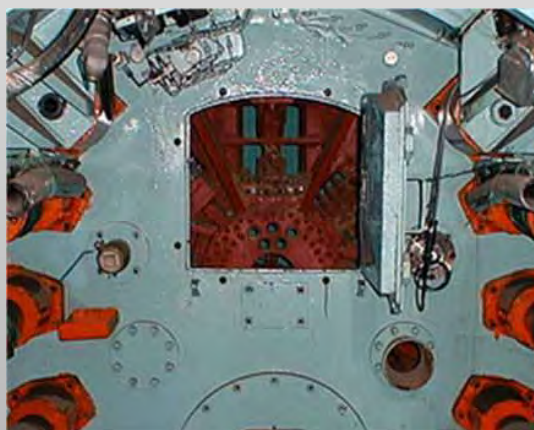
開放された点検扉
