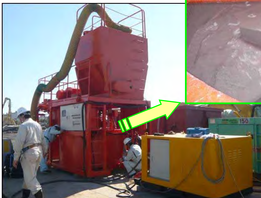
スラリープラント
