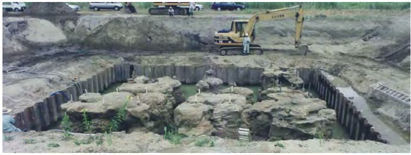
写真-3 1999年 固結状況開削確認
