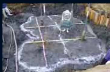
固結状況開削確認
