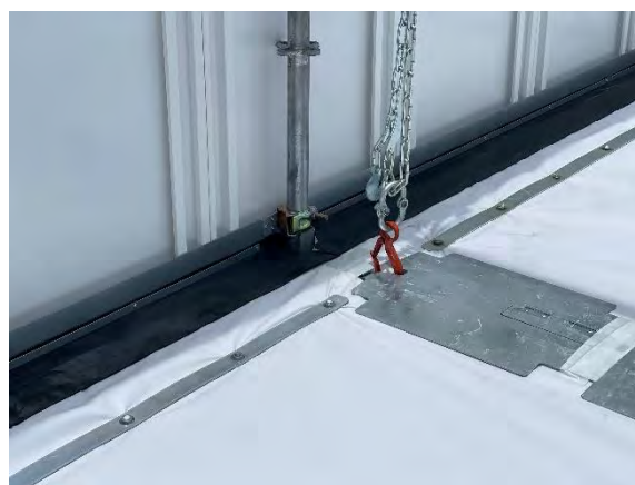
防護柵と作業床のすきまからの落下を防ぐ。
