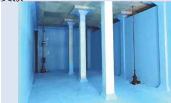
上水道用配水池の実績
