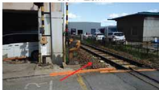
写真-3 落下状況
