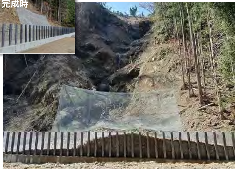
写真-1 崩壊土砂を捕捉(約1000m³)
