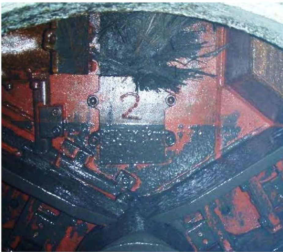
スリット閉塞状況
