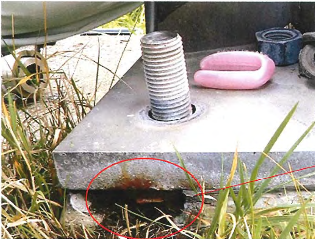
(a) 基礎モルタル部に腐食あり
