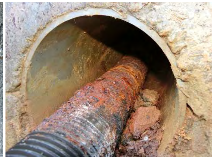
腐食状況②
