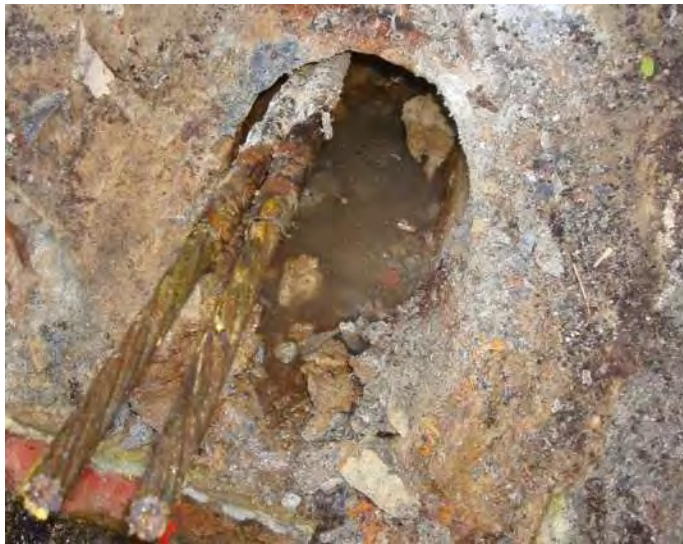
水が溜まっている状態
