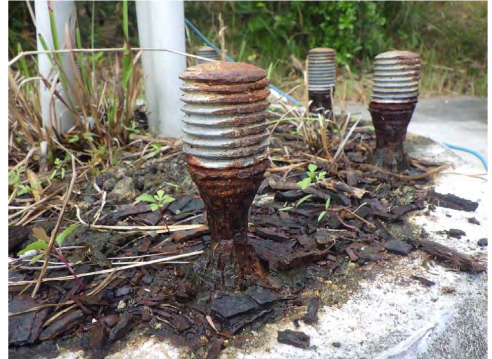
アンカーボルト欠損状況の一例
