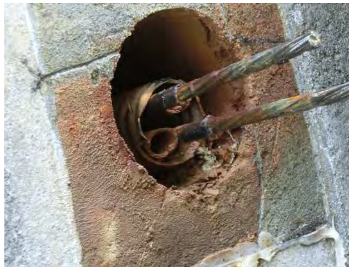
腐食状況①
