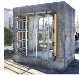
『ボックスカルバートモデル』 損傷事例を見える化
