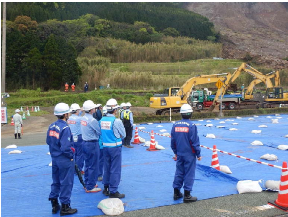
【写真】専門家を交えた現地調査をおこなう九州技術事務所 TEC-FORCE 隊 南阿蘇村立野地区の大規模崩落箇所にて（4月23日 13時ごろ撮影）
