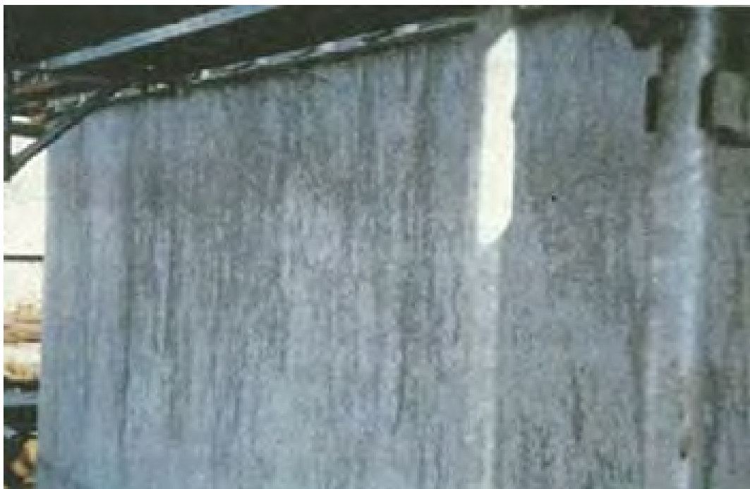
砂すじ損傷写真
