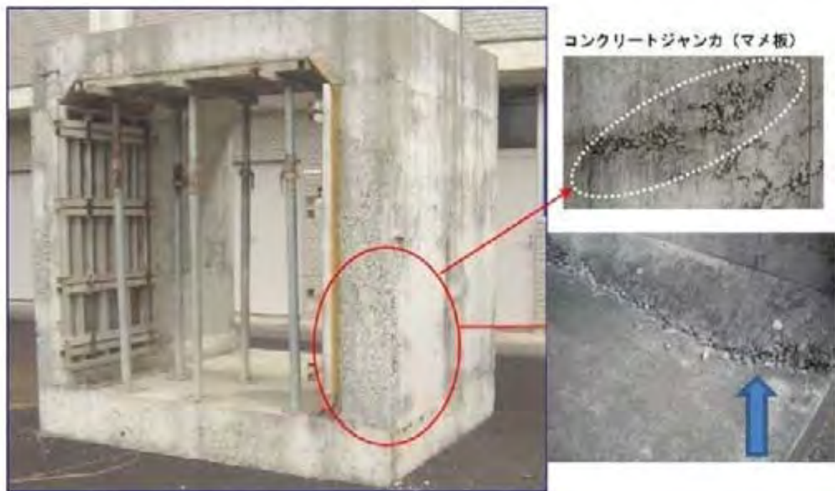
豆板損傷写真
