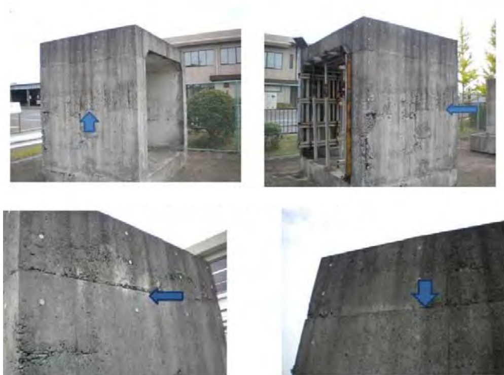
コールドジョイント損傷写真
