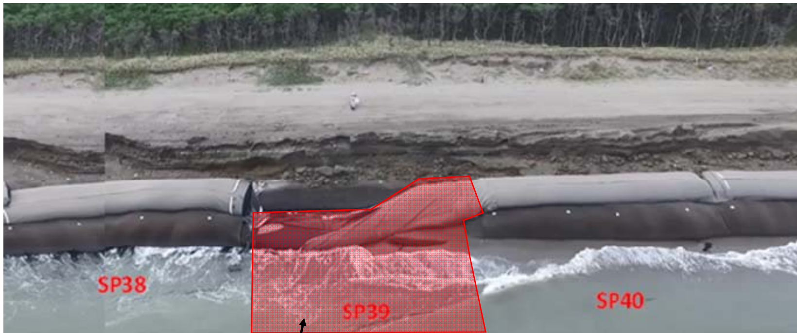
大炊田SP39変状写真 (2017(H29)年10月24日ドローンによる撮影)
