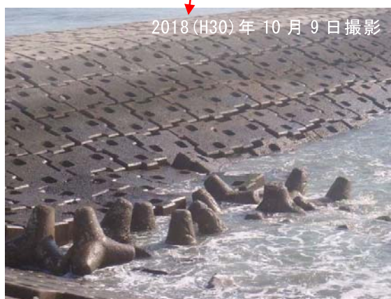
南側被覆ブロック変状
