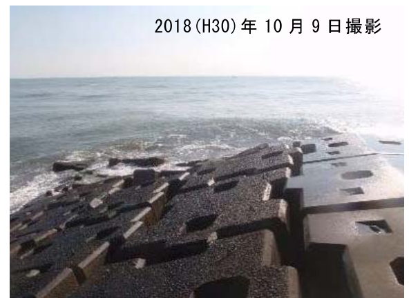
先端ブロック一部崩壊
