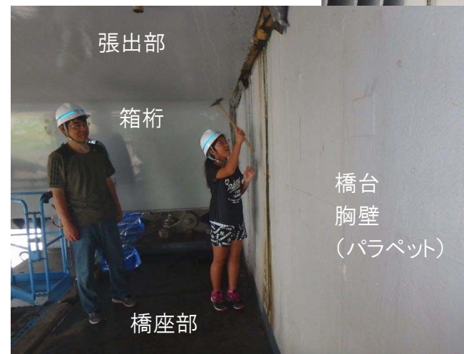
③コンクリートを叩いて、浮いているところの音を確認しました また、雨水が漏れているところ、鉄筋が出ているところを確認しました
