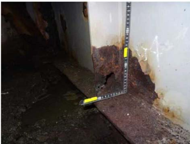
国管理 主桁腐食・欠損
