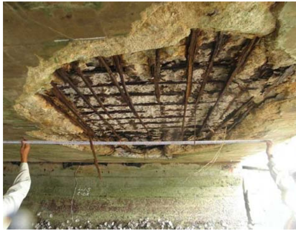
地方自治体管理 床版鉄筋露出
