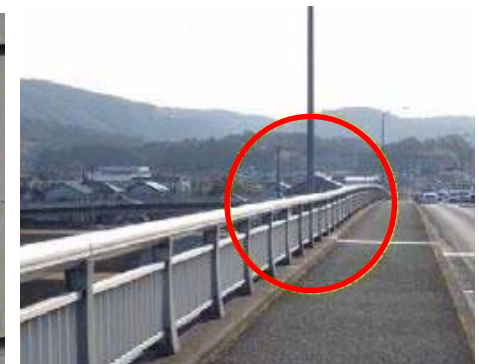
▲中央ヒンジ部の垂れ下がり
