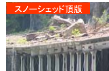
▲崩土等の堆積
