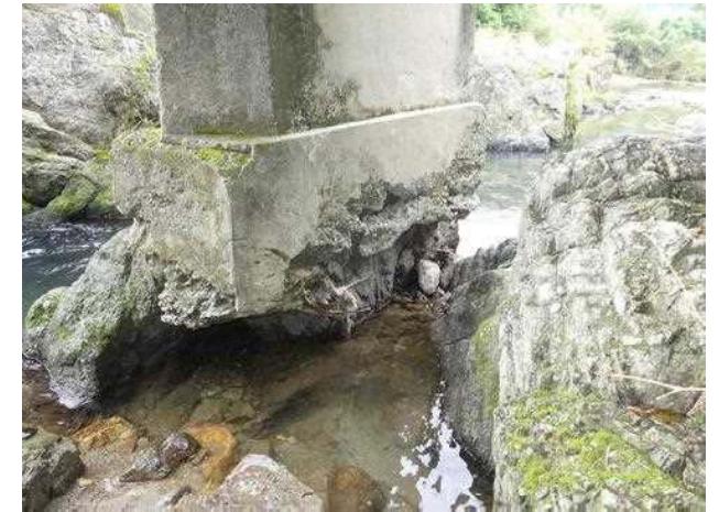
地方自治体管理 橋脚洗掘
