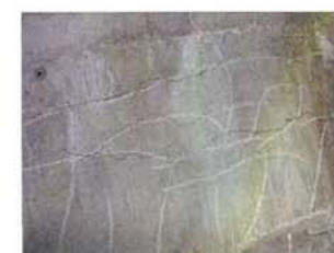
下部工のひび割れ
