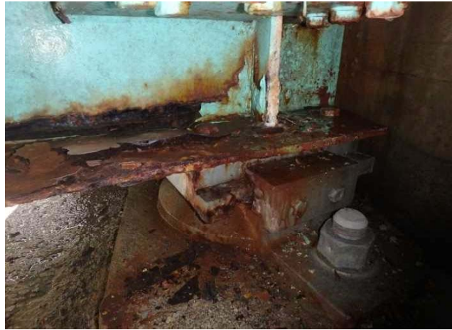
地方自治体管理 主桁腐食
