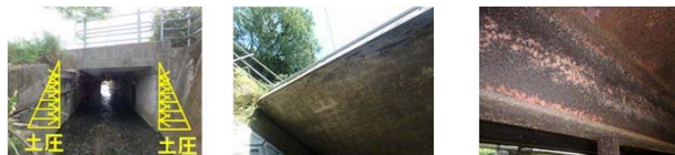
▲溝橋 変状項目
