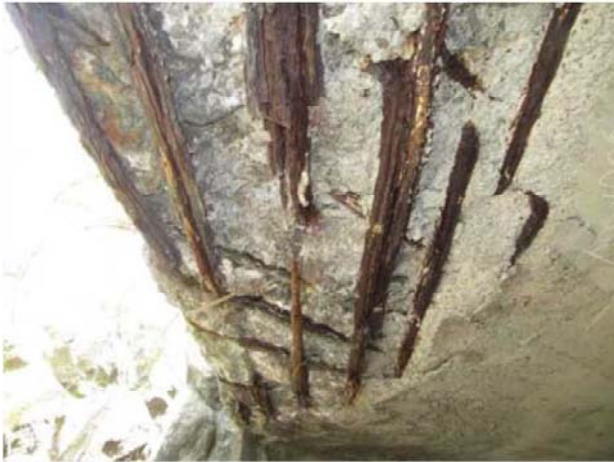
国管理 床版鉄筋露出 ※床版: 橋の裏側
