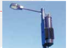
狭い歩道等では、スペース確保のため柱状型トランスを設置。
