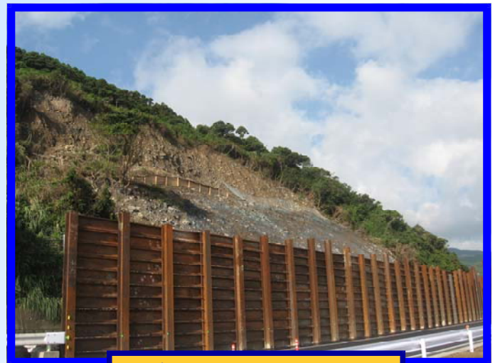
現在の災害現場の様子
