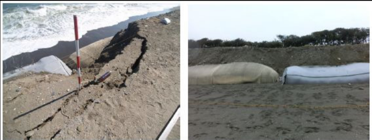
写真 I-2.2.5 突き合わせが悪い場合に生じる局所的な侵食
