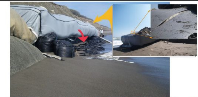
写真 I-2.2.1 海浜の短期的地形変化による地盤低下による下層の破損と上層の変形破裂
