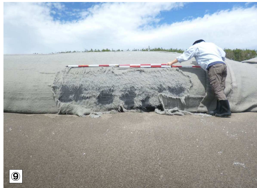
写真－ 1.18 上段サンドパット外側シートの摩耗流出（平成 26 年 8 月 10 日）
