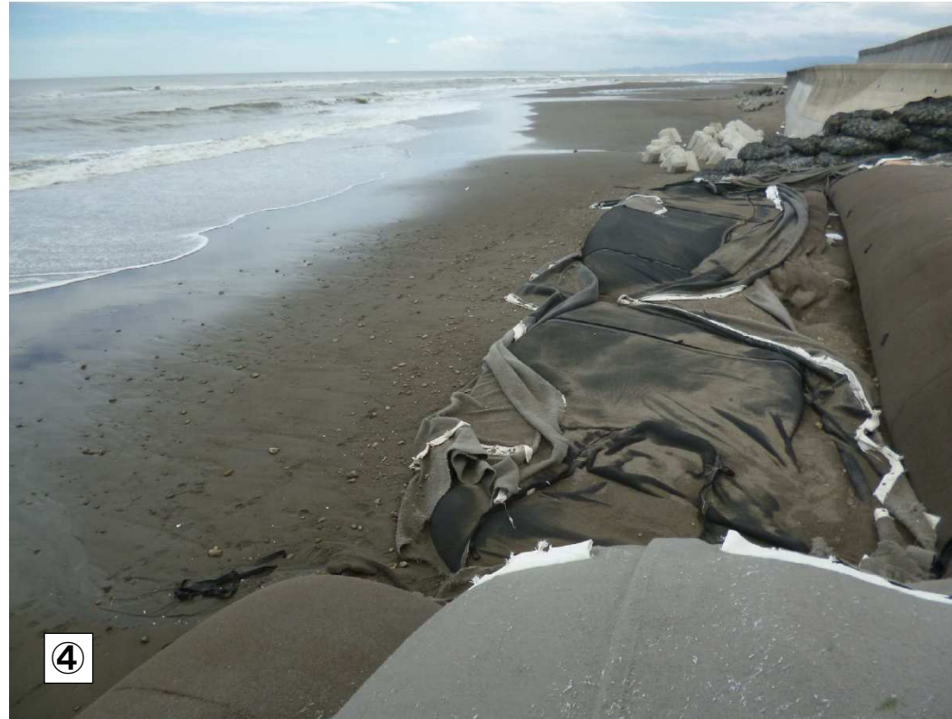
写真ー 1.13 南端のサンドバックの変状（変状箇所 A，平成 26 年 8 月 10 日）
