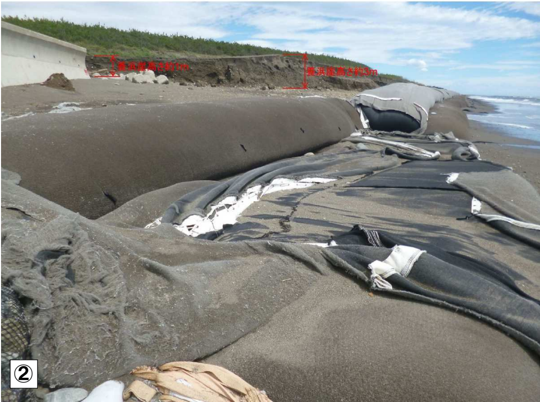
写真ー 1.11 南端のサンドバックの変状（変状箇所 A，平成 26 年 8 月 10 日）
