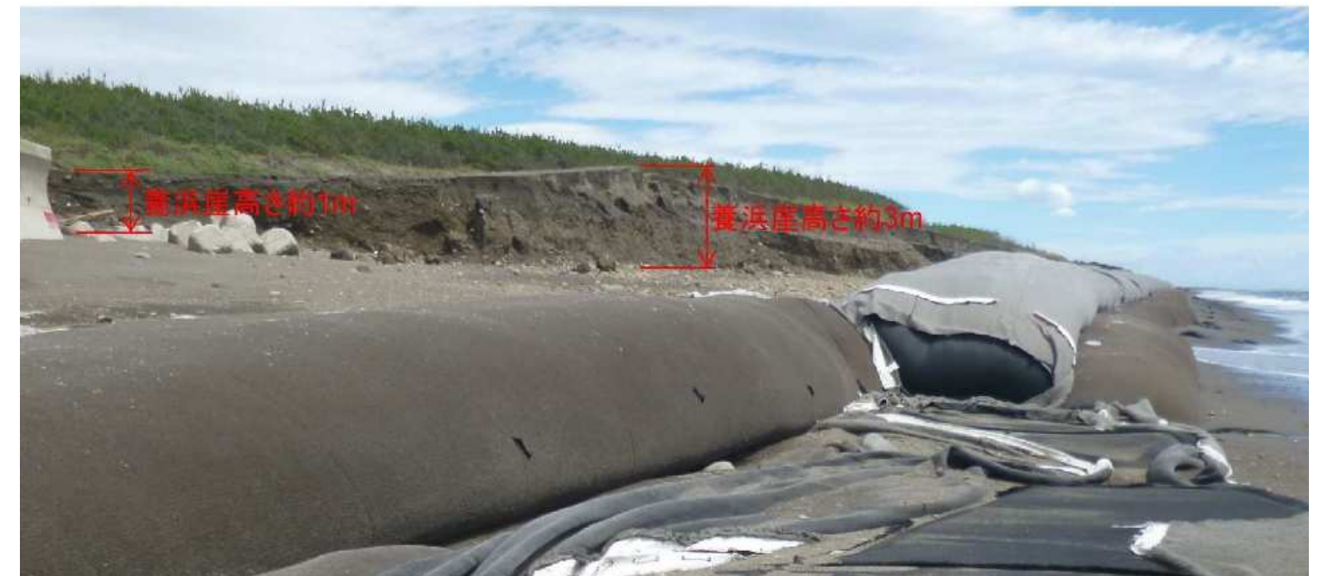
写真－ 3.2 サンドバック変状箇所 A の背後養浜の段差形成状況（平成 26 年 8 月 10 日撮影）
