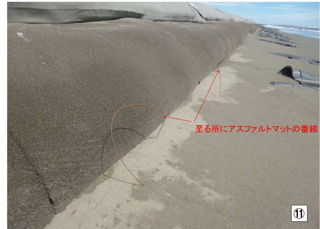
写真－ 1.20 アスファルトマットの番線の飛び出し（平成 26 年 8 月 10 日）
