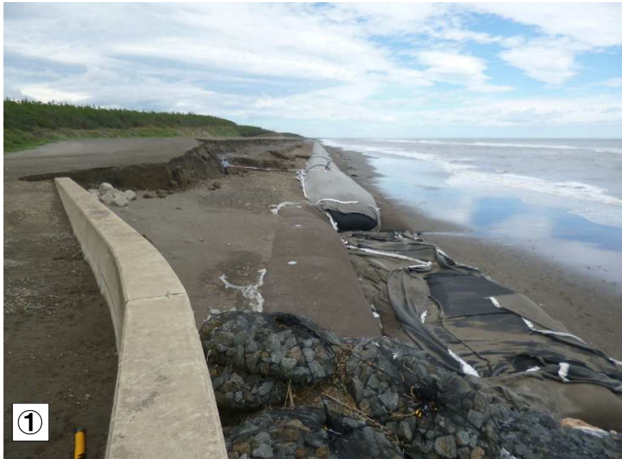
写真ー 1.10 南端のサンドバックの変状（変状箇所 A，平成 26 年 8 月 10 日）
