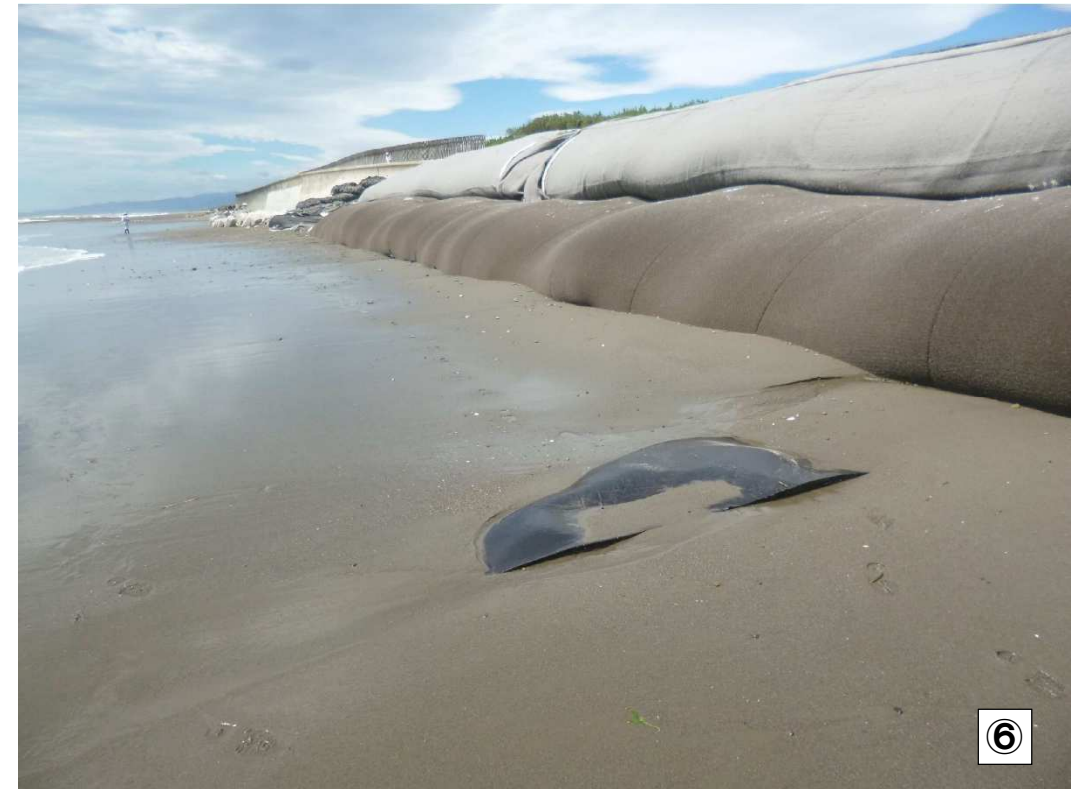
写真ー 1.15 アスファルトマットの露出状況（平成 26 年 8 月 10 日）
