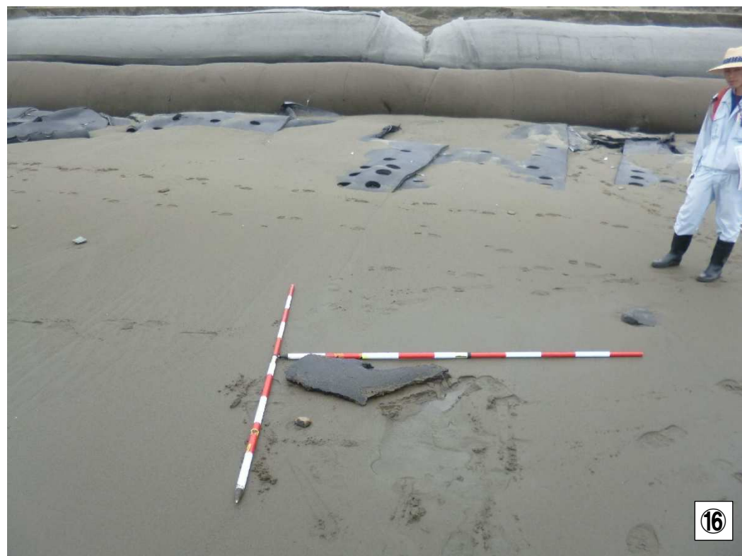
写真ー 1.25 アスファルト片の流出（平成 26 年 8 月 10 日）
