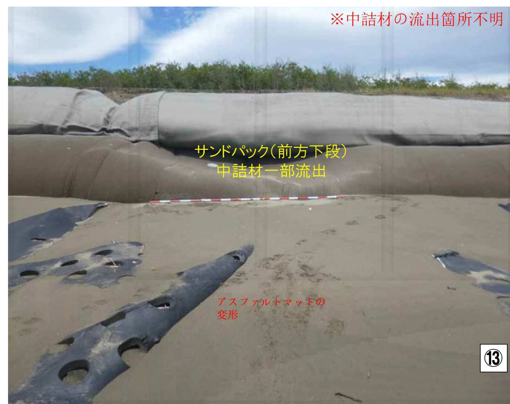
写真－ 1.22 サンドバックの損傷、中詰材流出（変状箇所D，平成 26 年 8 月 10 日）
