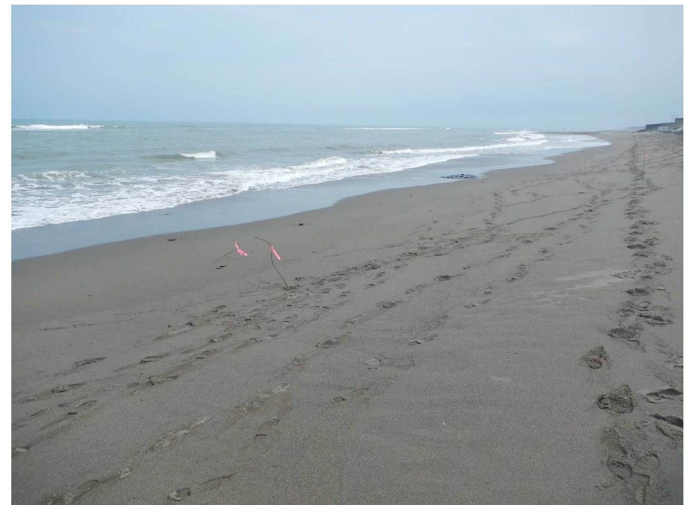
写真－ 3.5 アスファルトマットの番線が砂浜から突き出ている状況及び応急措置の状況 （平成 26 年 8 月 12 日撮影）
