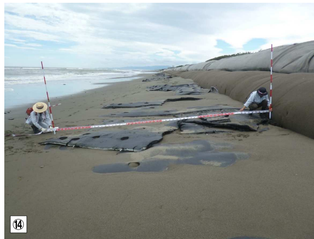
写真－ 1.23 アスファルトマットの流出（平成 26 年 8 月 10 日）
