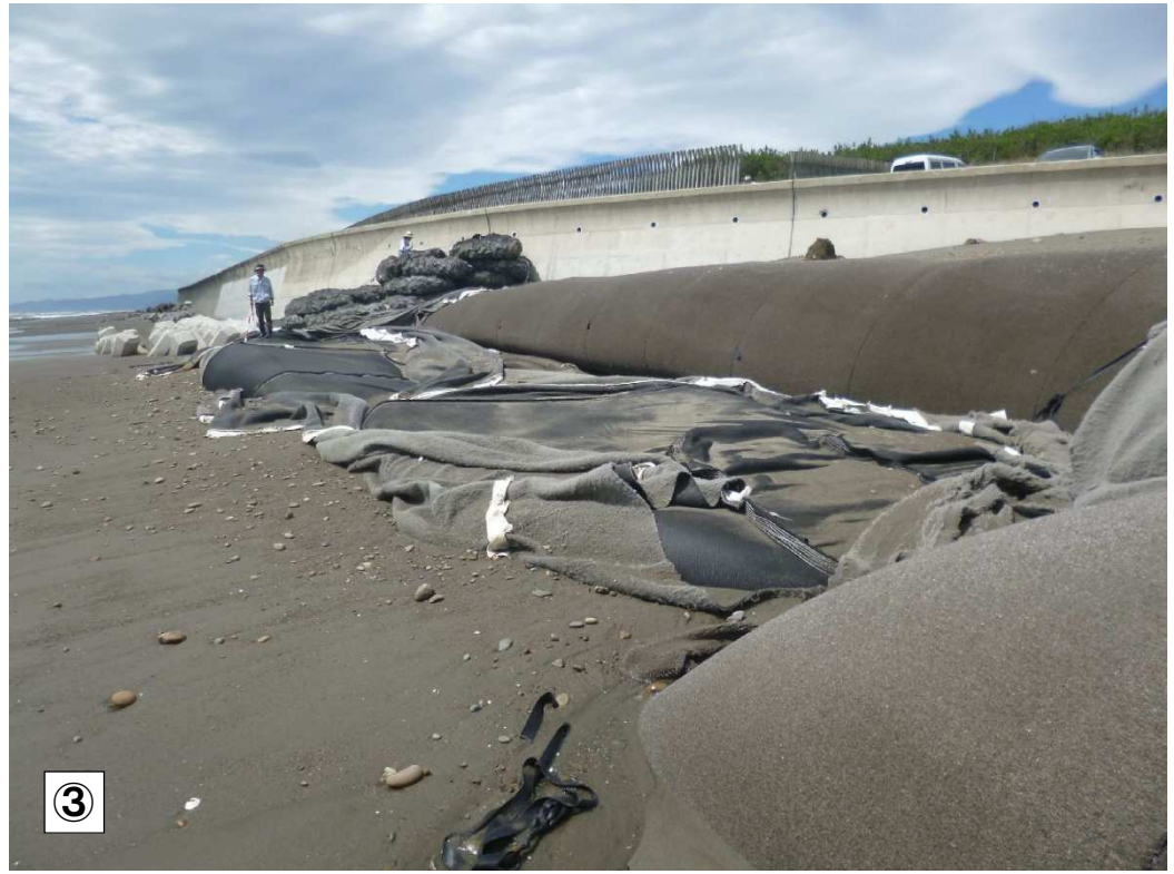
写真ー 1.12 南端のサンドバックの変状（変状箇所 A，平成 26 年 8 月 10 日）
