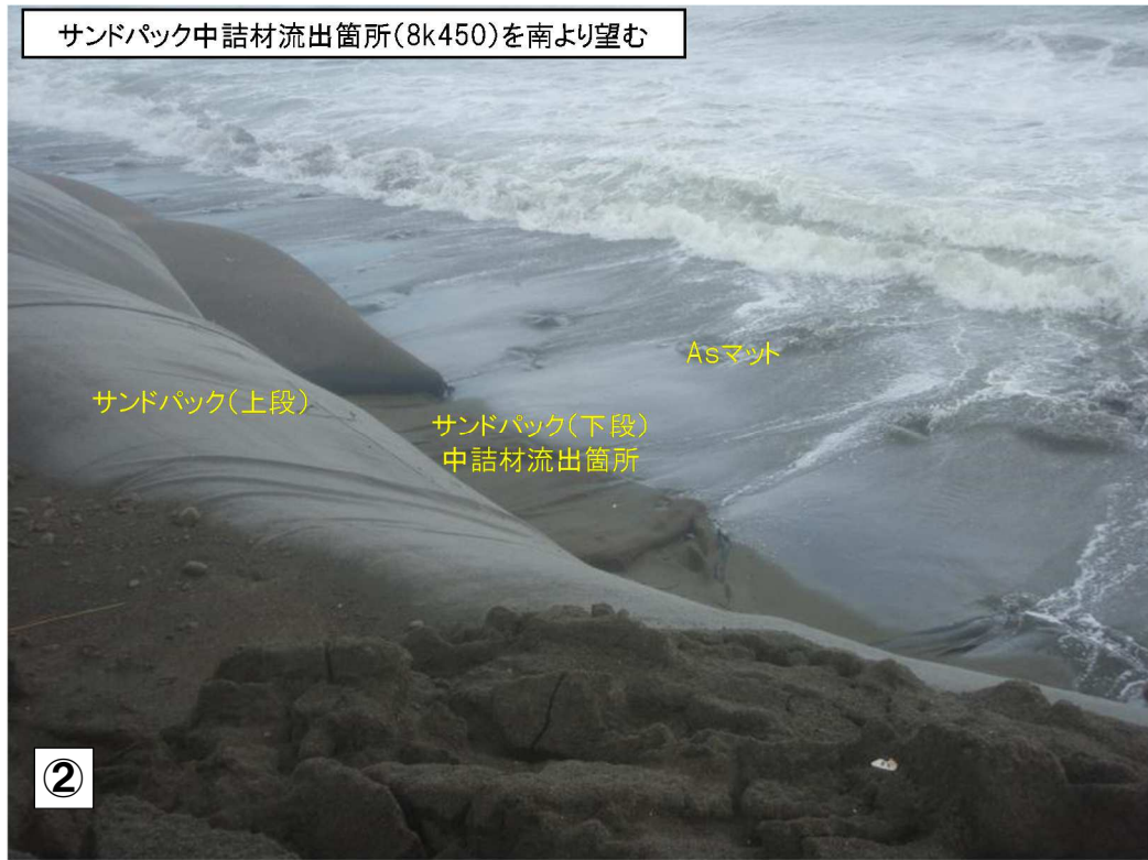
写真－ 1.1(1) サンドバック中詰材流出状況（平成 26 年 8 月 7 日）
