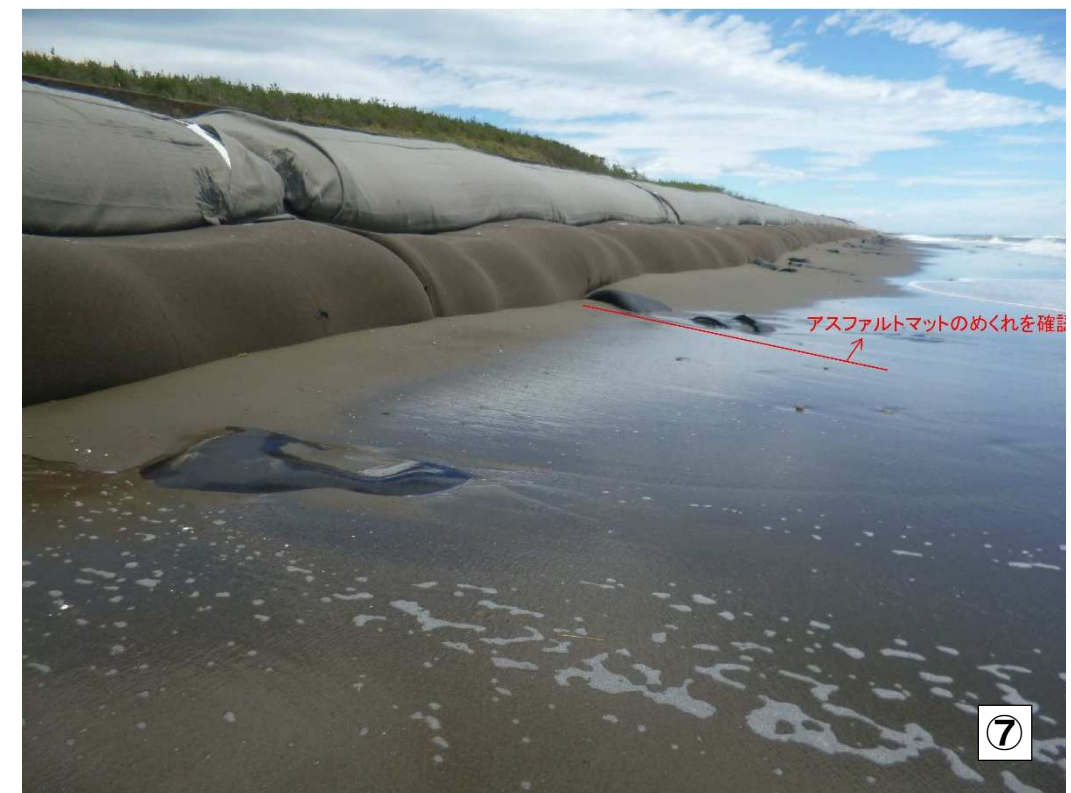
写真ー 1.16 アスファルトマットのめくれの状況（平成 26 年 8 月 10 日）
