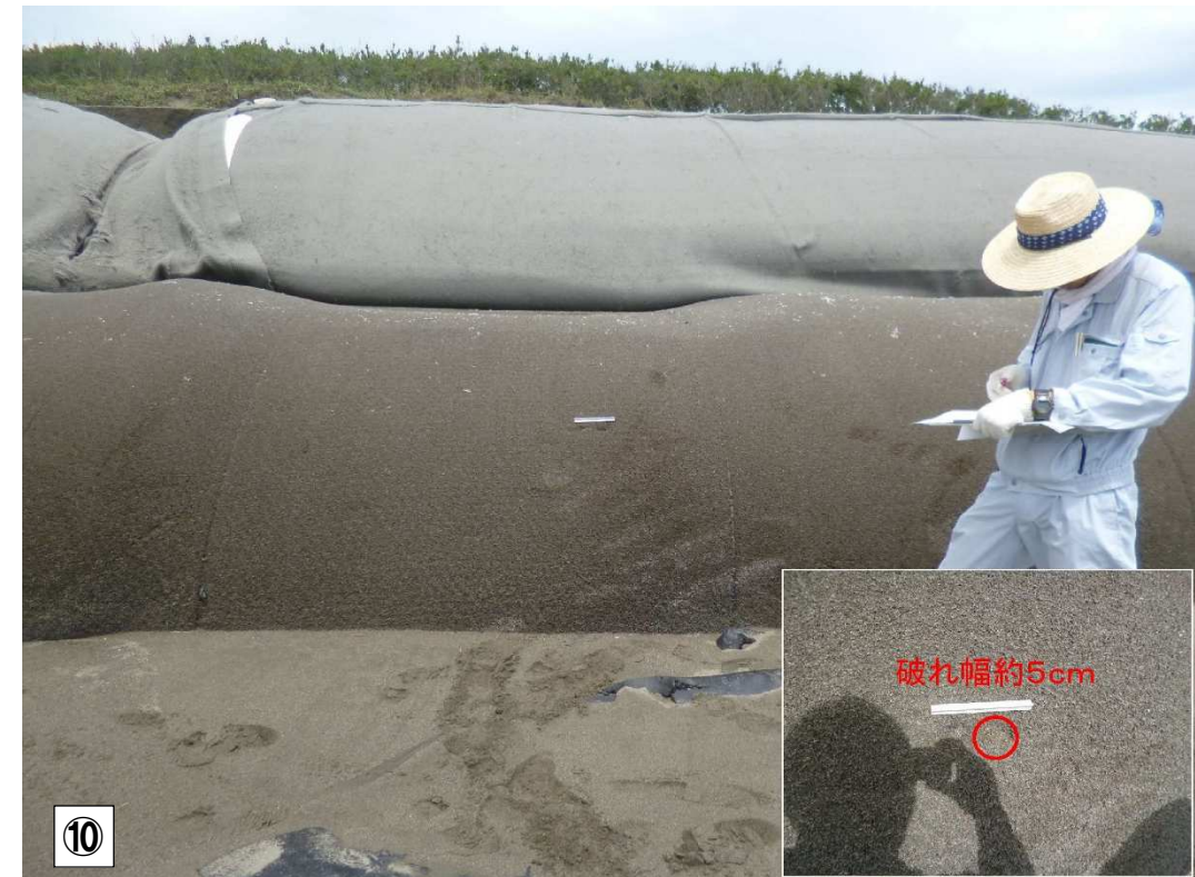
写真－ 1.19 サンドパットの損傷（変状箇所C，平成 26 年 8 月 10 日）
