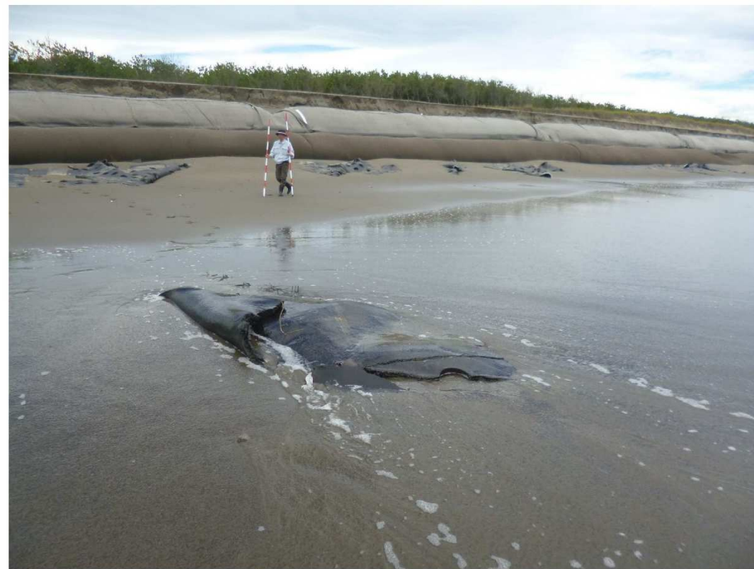
写真－ 3.1 アスファルトマットのめくれ及び破損状況（平成 26 年 8 月 10 日撮影）
