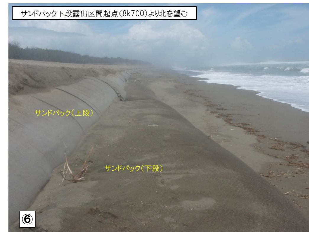
写真ー 1.2 サンドバック露出状況（平成 26 年 8 月 7 日）
