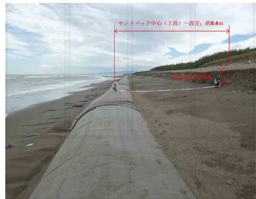
写真－ 3.3 変状箇所が複数確認された南端部 300m よりも北側区間の背後養浜の段差状況（平成 26 年 8 月 10 日撮影）
