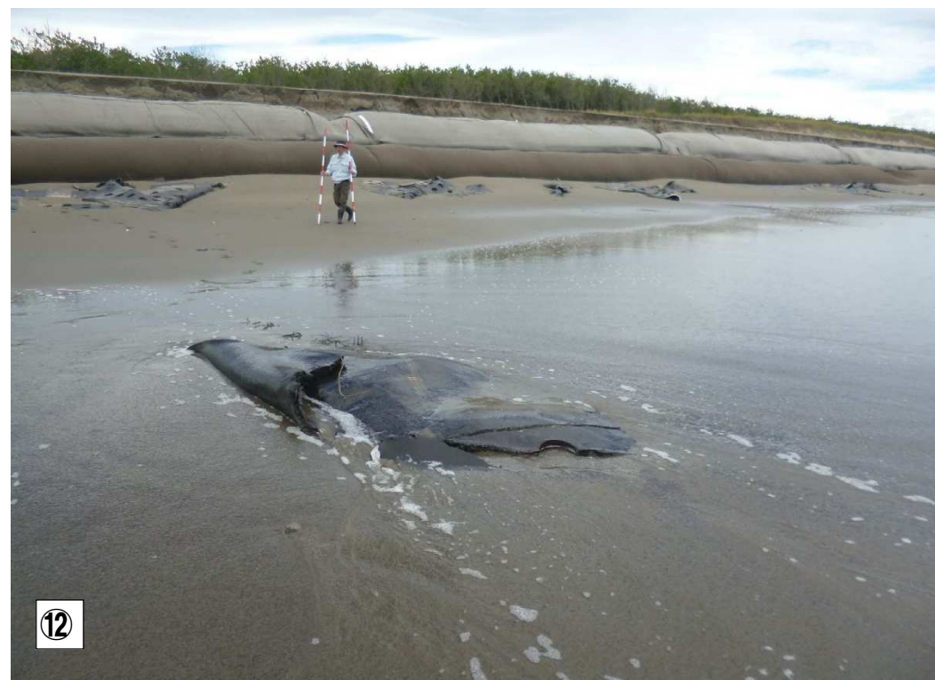
写真－ 1.21 アスファルトマットの流出（平成 26 年 8 月 10 日）
