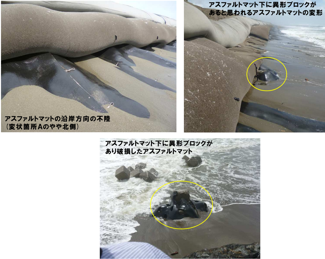
写真－ 2.1 8 月 7 日の変状箇所 A の周辺の状況
