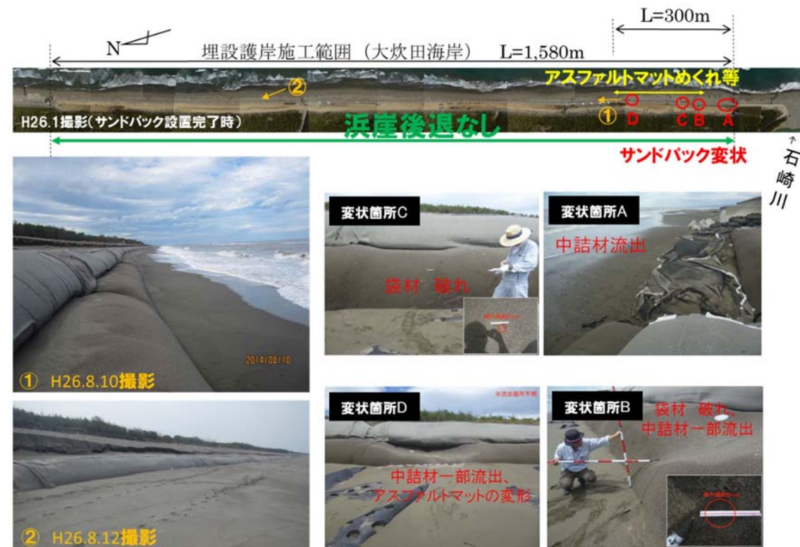
図－ 1.2 埋設護岸による浜崖後退防止とサンドバック、洗掘防止工の変状
