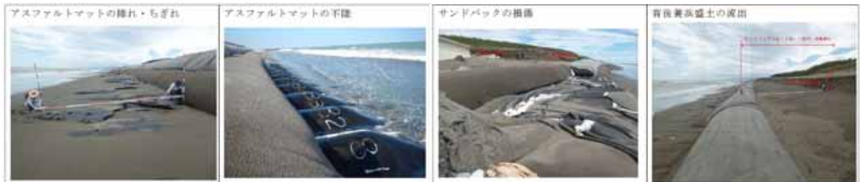
写真－ 3.2 埋設護岸の変状
