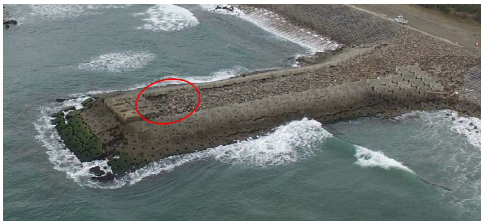
写真－ 3.1 本突堤天端の捨石移動状況 (2015 (H27) 年 12 月 2 日撮影)
