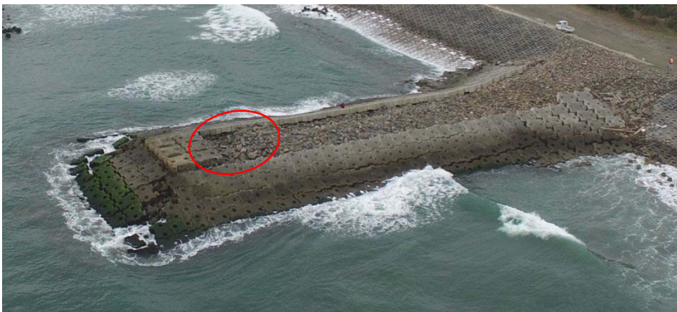
写真-2 本突堤天端の捨石移動状況 (2015 (H27) 年 12 月 2 日撮影)
