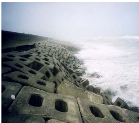
平成16年に来襲した台風によって被災した護岸
