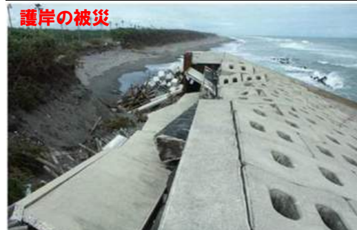
【台風14号後】平成17年9月11日撮影
