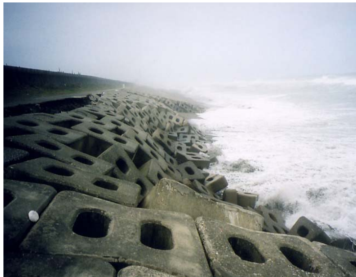
台風16・18号来襲時に被災した住吉地区緩傾斜護岸 <平成16(2004)年>
