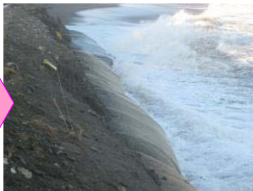
サンドバックが露出し波が直接当たる (平成24年10月13日撮影)
