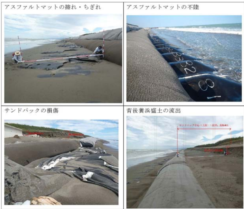
写真 埋設護岸の変状
