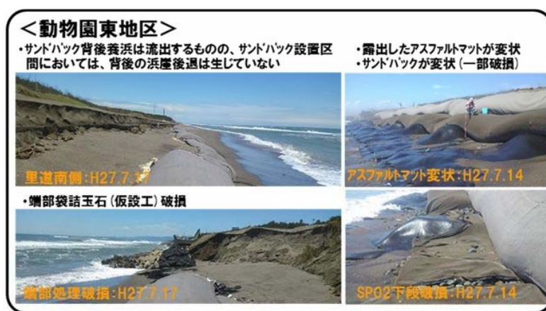
写真 動物園東地区における埋設護岸の変状当初の状況
