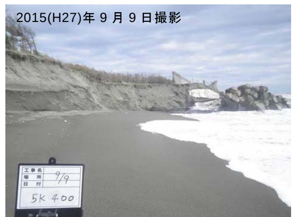
写真 5k400(動物園東)侵食状況
