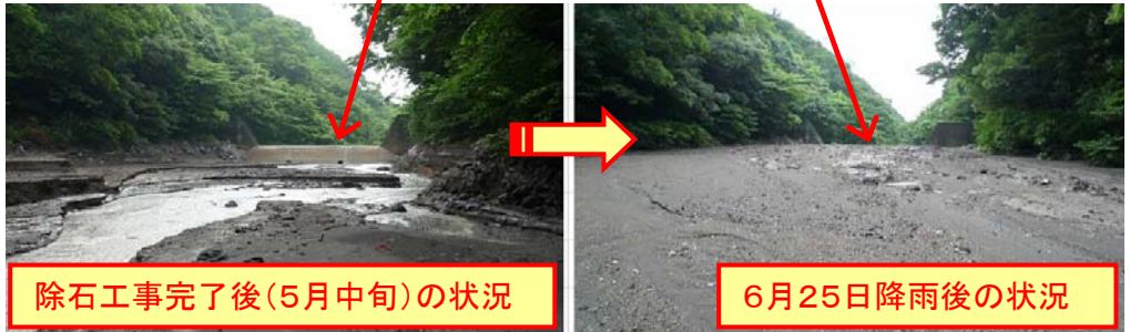
砂防ダムの天端まで土砂が堆積
