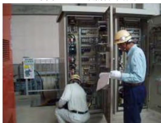
写真 4-3-5 電気設備の点検状況
