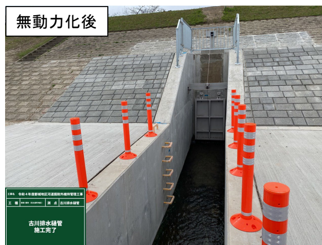
無動力化の事例(古川排水樋管)
