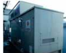
災害拠点病院等125箇所の自家発電設備の増設等の支援
