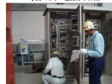
写真 4-3-5 電気設備の点検状況
