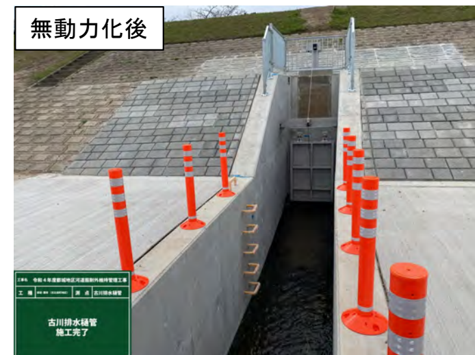
無動力化の事例（古川排水樋管）
