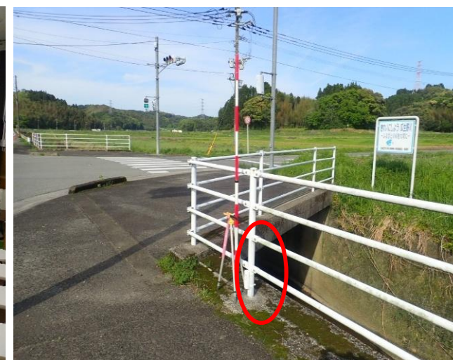
浸水センサ設置状況（宮崎市内）
