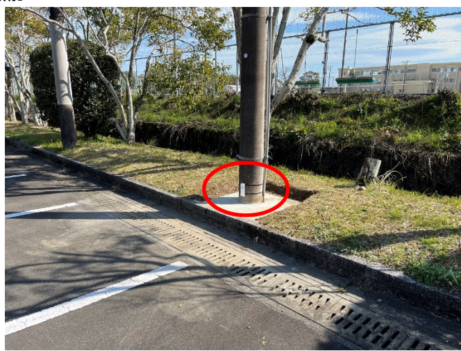
浸水センサ設置状況（高鍋町内）
