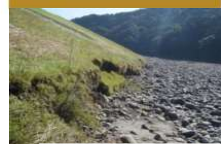
【堤防表のり尻の侵食】
