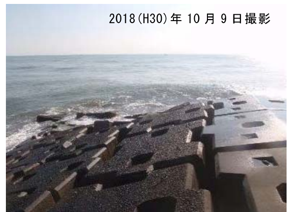
先端ブロック一部崩壊
