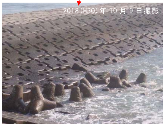
南側被覆ブロック変状
