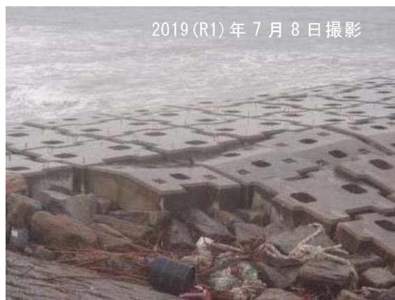
南側基部天端部の被覆ブロックの変状
