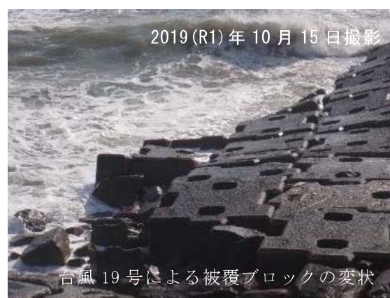
北側基部の被覆ブロックの変状
