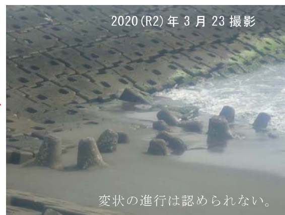
南側基部の被覆ブロックの変状
