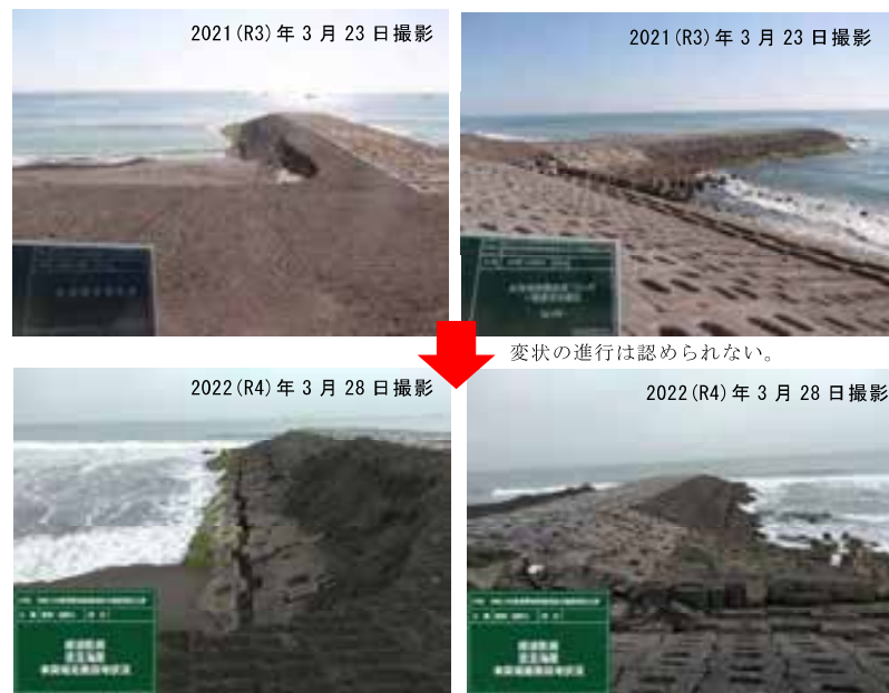
突堤の被覆ブロックの変状
