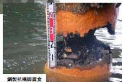
鋼製杭橋脚腐食
