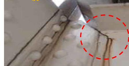
主桁(横桁)の損傷(亀裂)
