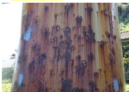
補強鋼板の腐食
