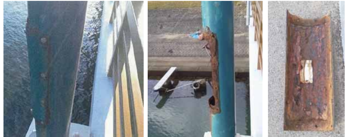
転倒した照明柱と同タイプの状況
