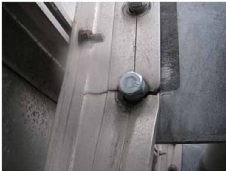
き裂損傷 (車両衝突)
