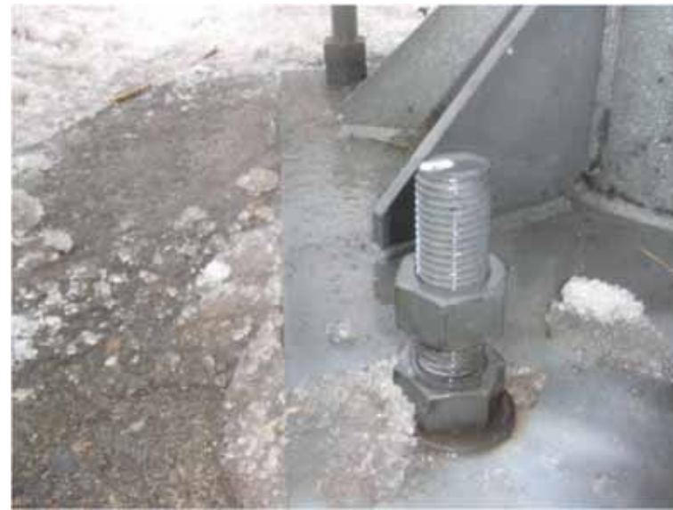
ボルトの緩み (施工不良)
