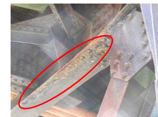
耐候性鋼材に層状の剥離
