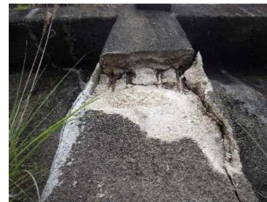
法枠工の老朽化損傷
