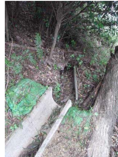
写真 排水溝の破損の例
