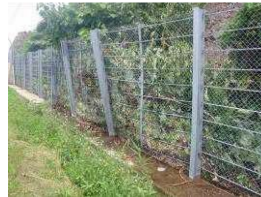
写真 落石防護柵の傾動の例
