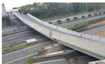
ロッキング橋脚を有する橋の落橋
