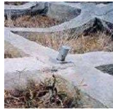
写真 受圧構造物の破損の例
