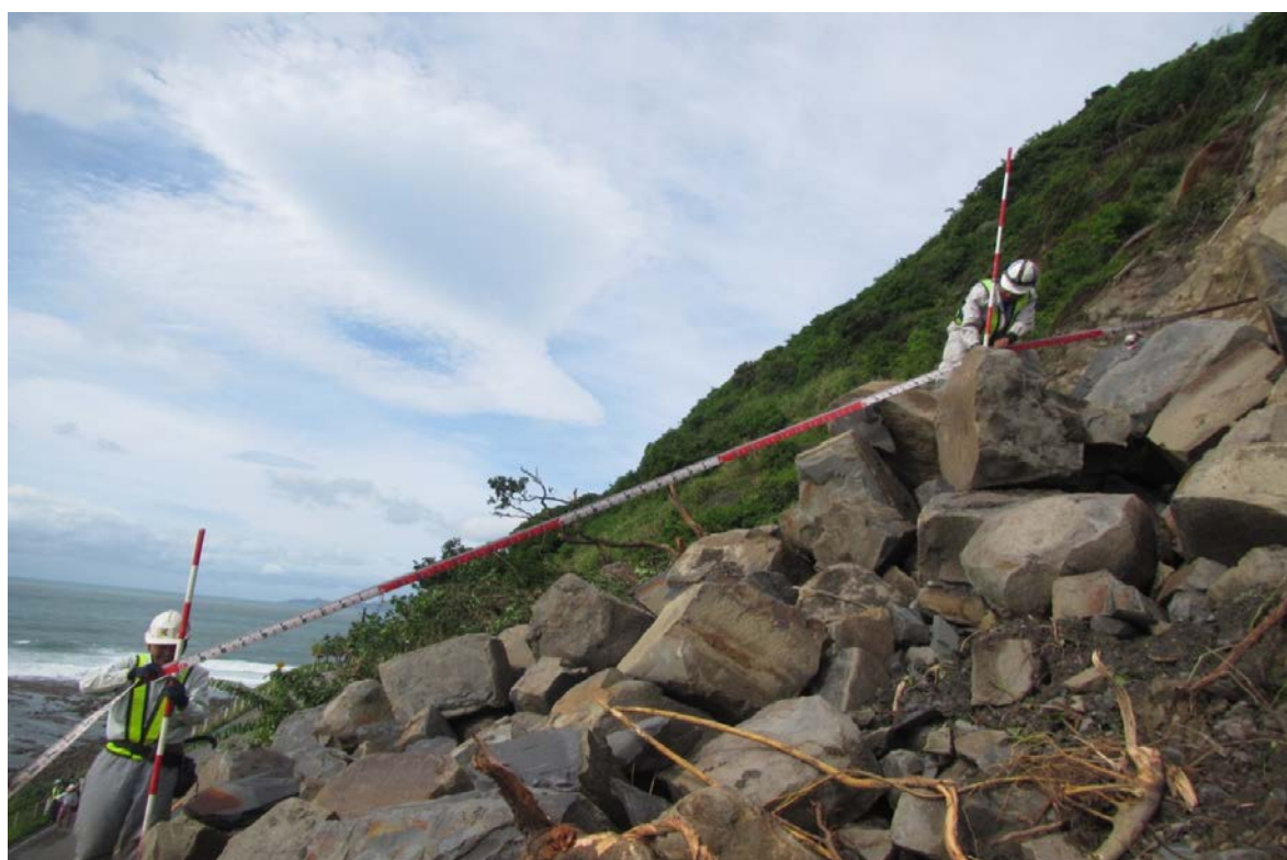
《崩壊状況②》6月21日8時頃
